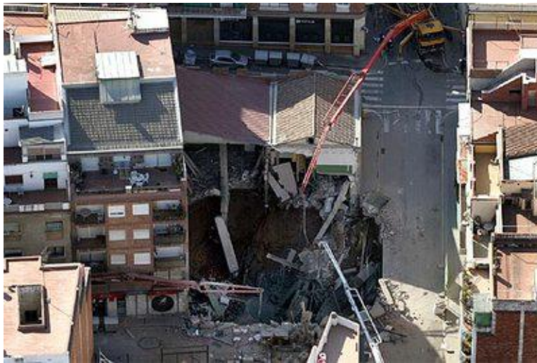
Figura 1.2 Colapso del túnel de Línea 5 del Metro de Barcelona
