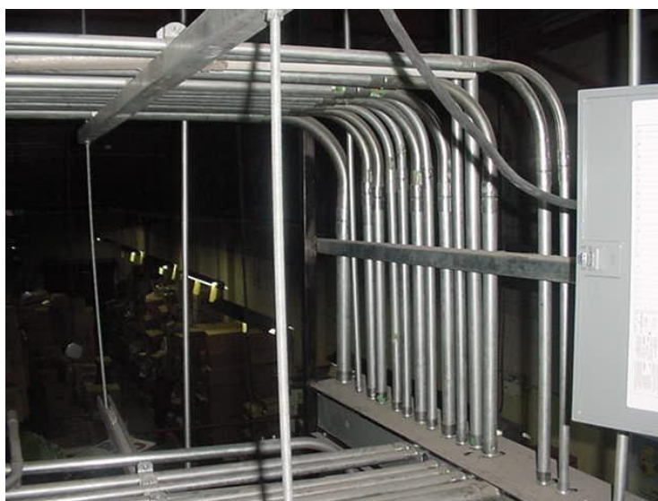
Figura 2.13 Tuberías de circuitos derivados.
