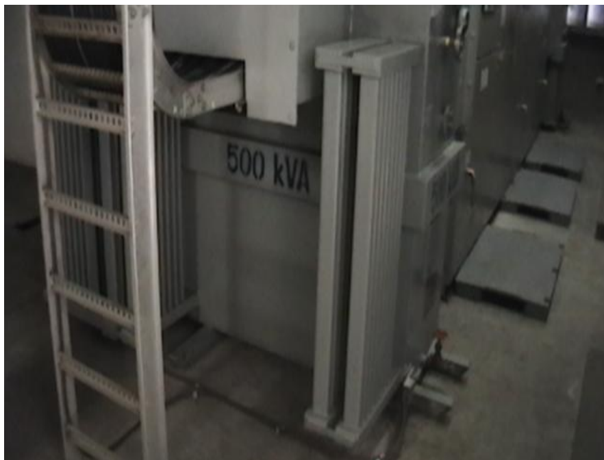
Figura 2.27 Transformador en aceite sin bóveda divisoria.
