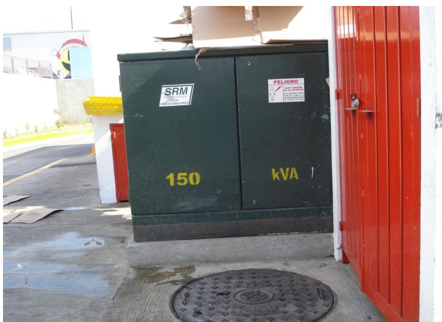
Figura 2.22 Subestación eléctrica tipo pedestal.
