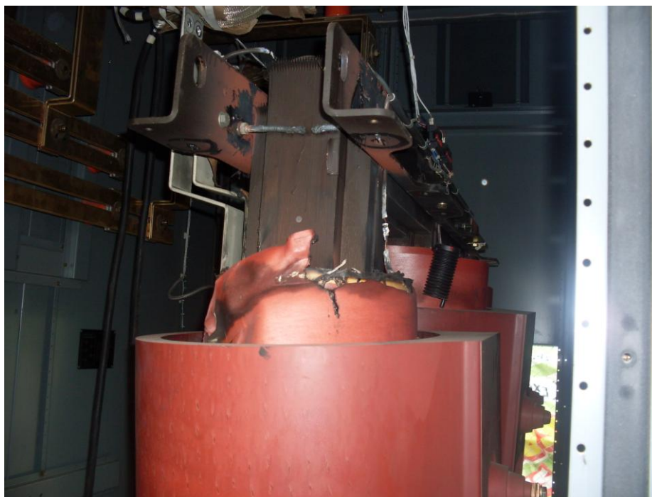
Figura 2.26 Transformador tipo encapsulado quemado.
