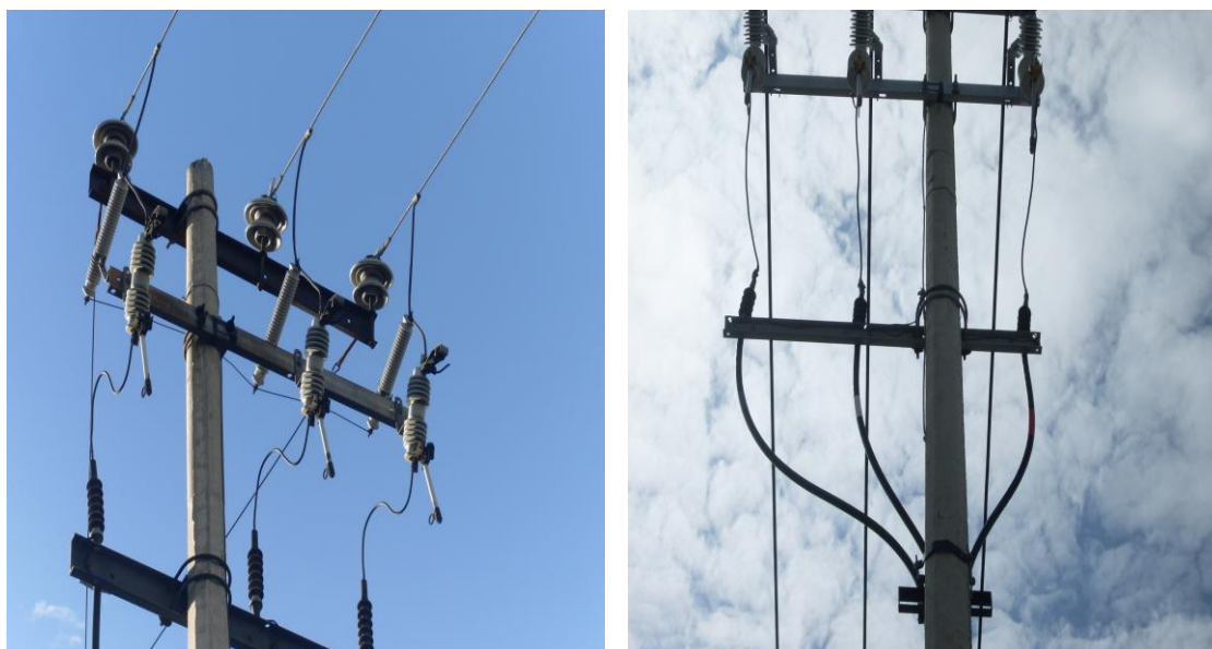
Figura 2.18 Acometida y transición de área-subterránea en M.T.
