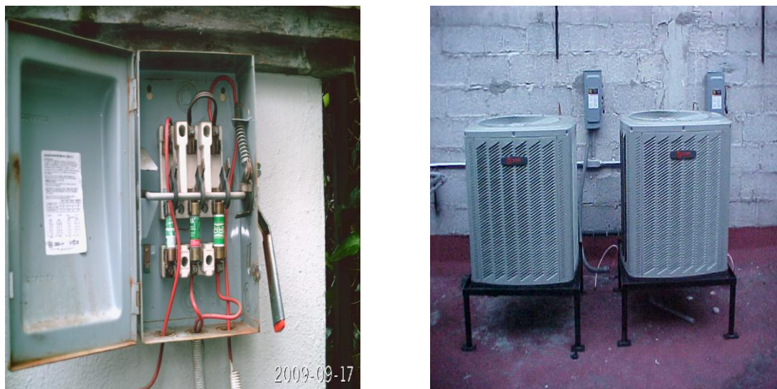
Figura 2.10 Dispositivo de protección de equipos de aire acondicionado.
