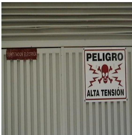
Figura 2.28 Leyenda de peligro en puerta de subestación.
