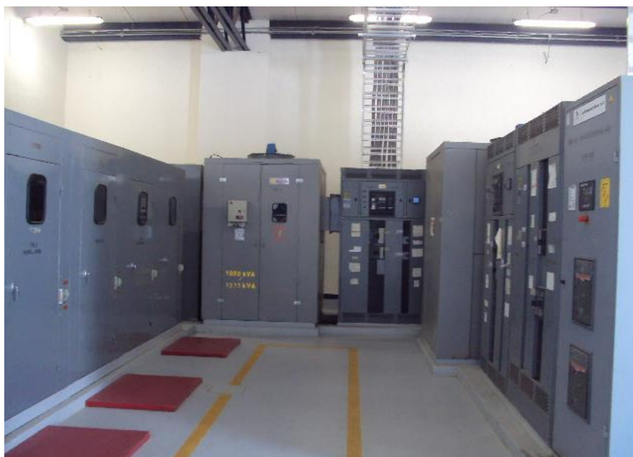
Figura 2.21 Subestación eléctrica tipo interior.
