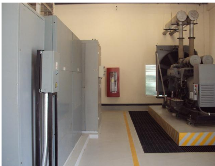
Figura 2.24 Planta de emergencia y gabinetes de subestación.
