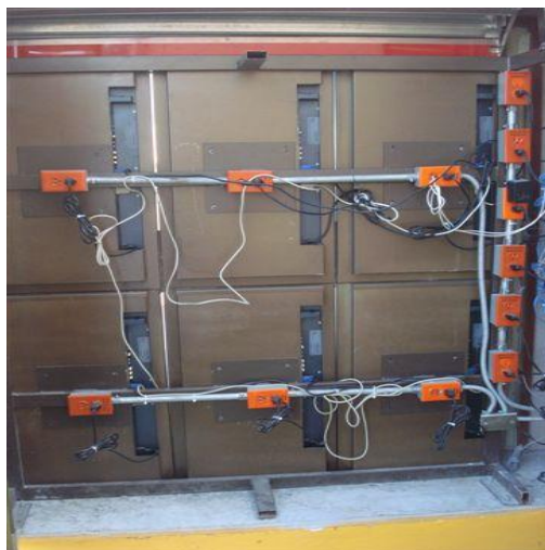
Figura 2.8 Buena distribución, mal cableado.
