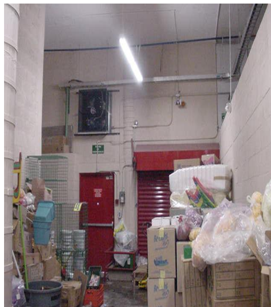
Figura 2.3 Luminario tipo suspensión en área de recibo.
