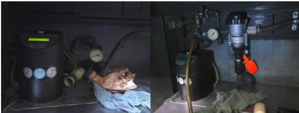
Imagen 4.8 Sistema de llenado automático antes (izq.) y después de la reparación (der.).
