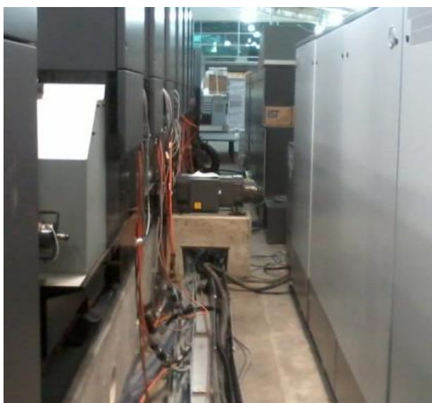
Imagen 4.3 Disposición del cableado de la prensa y los equipos periféricos.
