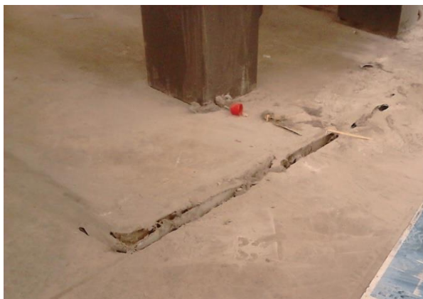
Imagen 4.4 Desfasamiento que se presentó en la base de operación de la prensa.
