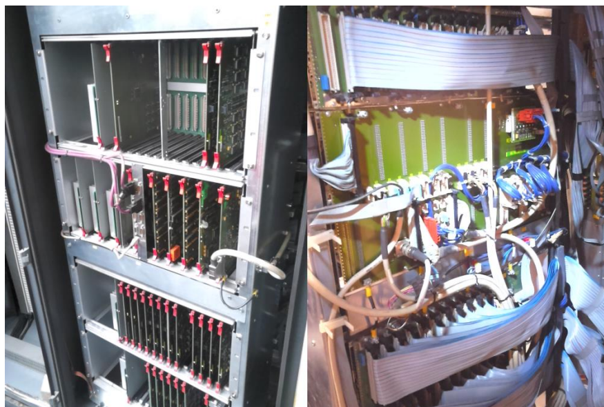
Imagen 4.10 Vista frontal y trasera de los racks de tarjetas de control del gabinete central.
