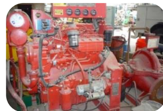
Bombas contra incendios.
