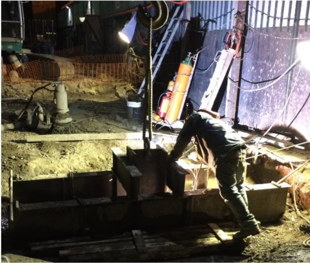
Fig. 4.24, Posición Final Puntal Metálico
