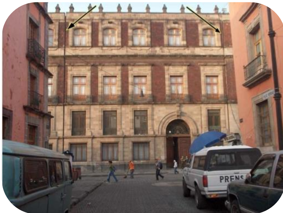
Figura (2.5) Pared norte de Palacio Nacional, las flechas indican las grietas a ambos lados de la puerta.
