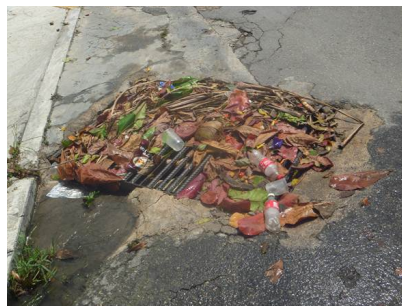
d) Rejilla de piso cubierta de basura acumulada por los escurrimientos de la lluvia
