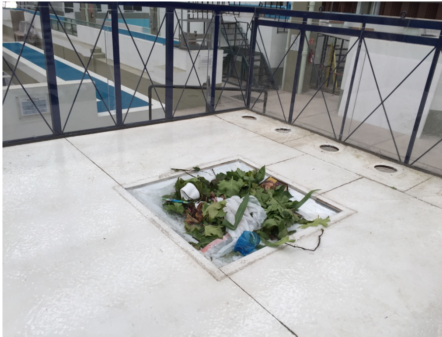
Figura 67 Arrastre de de desechos sólidos en la boca de tormenta
