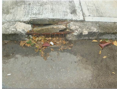
b) Boca de tormenta con basura de hoja, tierra acumulada y colapsada
