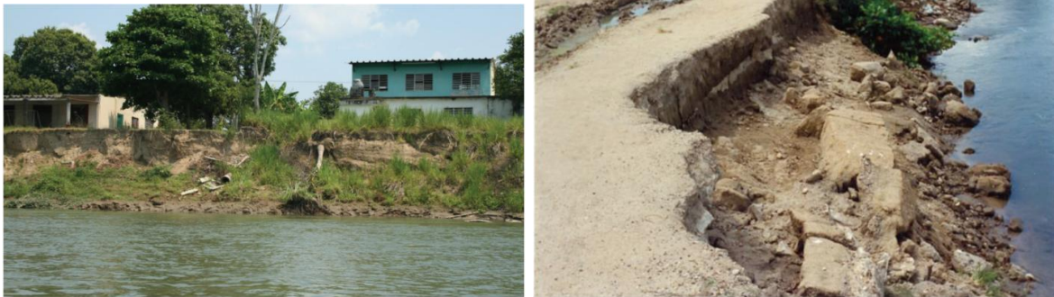
Figura 2.4.3 Afectaciones causadas orillas del río Mezcalapa ubicado en el estado de Tabasco, México. (Langendoen, 2013).
