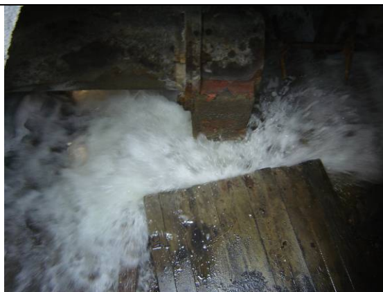
Figura 2.17 Caja de distribución mal acomodada
