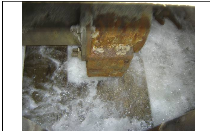
Figura 2.13 Caja de distribución muy pequeña.
