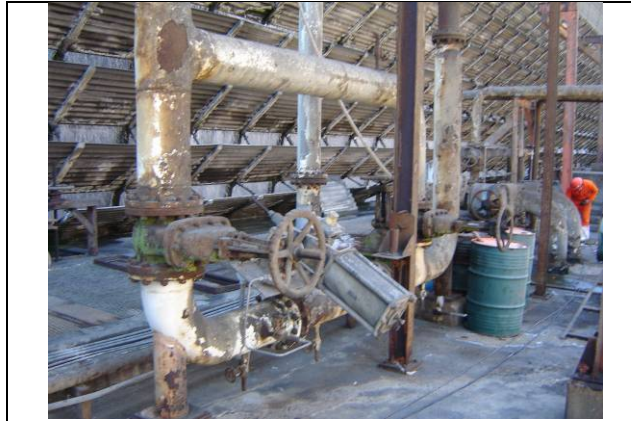
Figura 2.19. Válvula de agua de repuesto.
