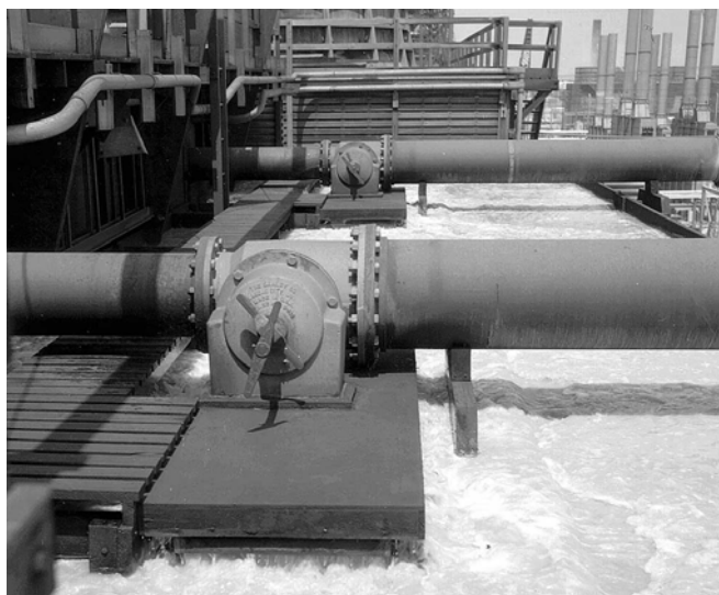
Fig. 2.18 Sistema de distribución con buen funcionamiento
