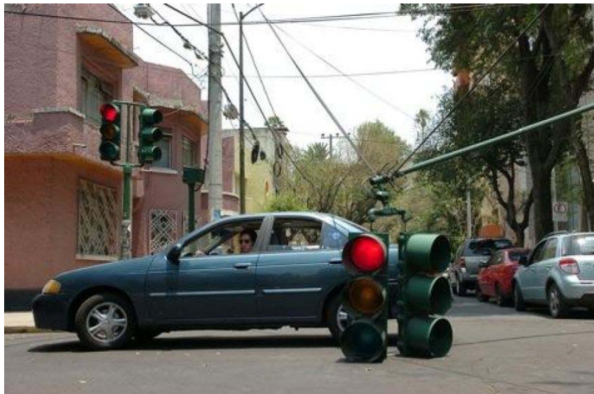
Figura 2.8 Falta de mantenimiento de semáforos Fuente: Nicolás Corte, Publimetro.
