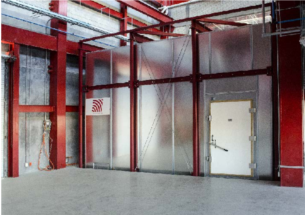
Figura 6.8 Exterior de la cámara semi anecoica, CAT UNAM, Campus Juriquilla Qro.
