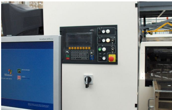
Fig. 9.15 Computadora con Focus Pilot y gabinete de control del Laser Rofin
