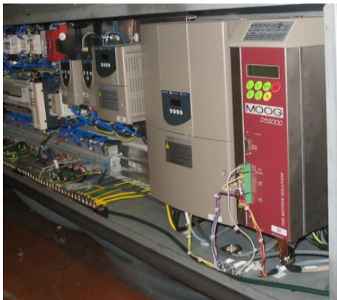
Fig. 9.12 Variadores de Y, X y del conveyor de una cortadora Laser Focus 15
