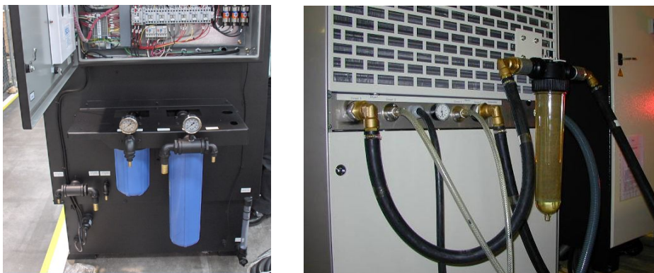
Fig. 9.5 Conexiones en sistema de enfriamiento Koolant Coolers
