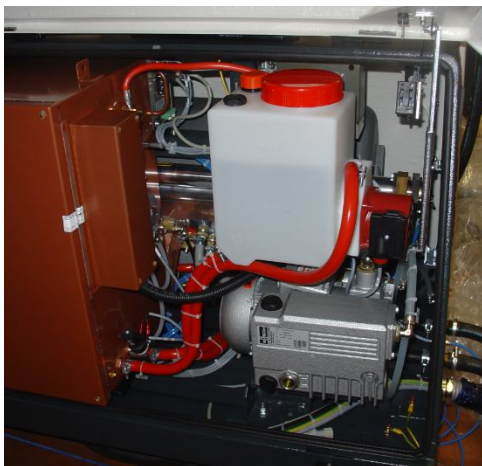
Fig. 9.17 Deposito contenedor de agua de enfriamiento del tríodo
