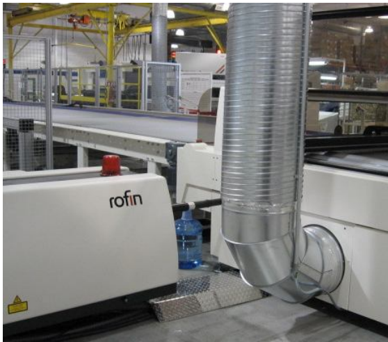
Fig. 9.6 Tubería de extracción de gases producto del corte
