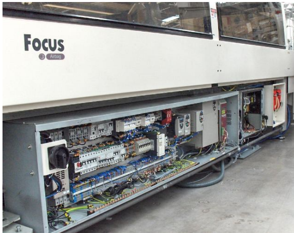
Fig. 9.8 Foto de cableado de encendido y seguridades de maquina laser Focus 15
