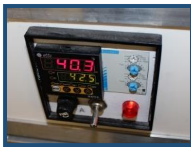
Figura 8. Control de Temperatura.
