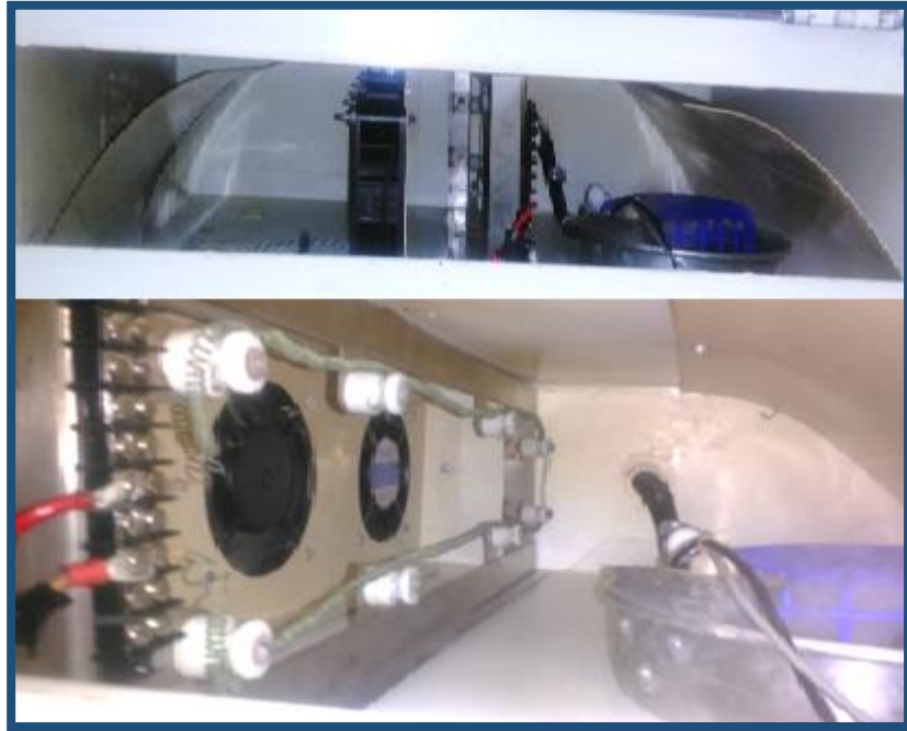
Figura 45. Cámara de calentamiento
