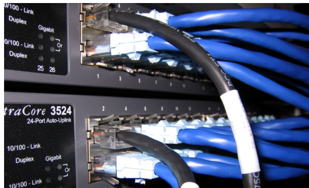
Figura 57. Conexiones en un switch Ethernet. 31
