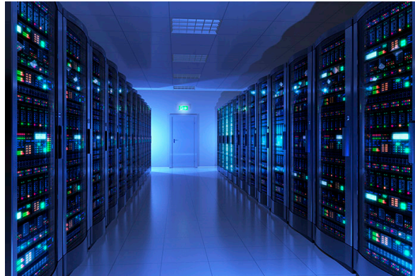
Figura 20. Ejemplo de una sala de servidores.
