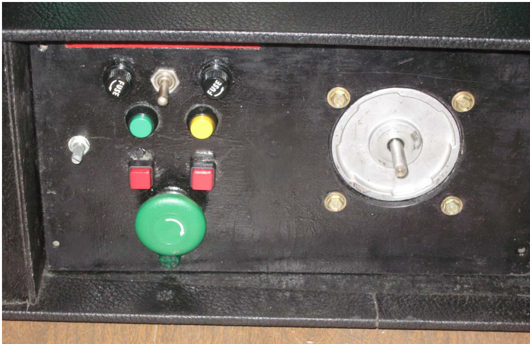
Figura 146 Modo de operación de control de entrada digital básico.
