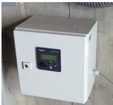
Ilustración 4. Analizador de redes Schneider Electric. PowerLogic ION 7330
