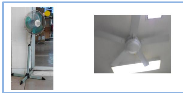
Ilustración 5. Ventiladores. Principal Equipo en el Sistema de Misceláneos.
