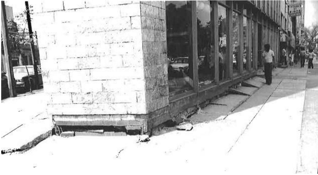
Figura C.14 "79m-A4" – Oficinas en insurgentes con problemas en la cimentación. (Meli, 1979)
