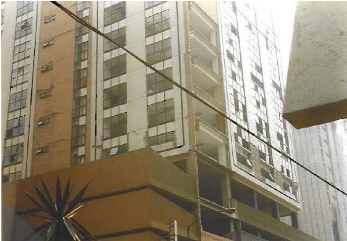
Figura C.20 "79m-C13" – Edificio desalojado por daños actuales y de sismos previos. (Meli, 1979)
