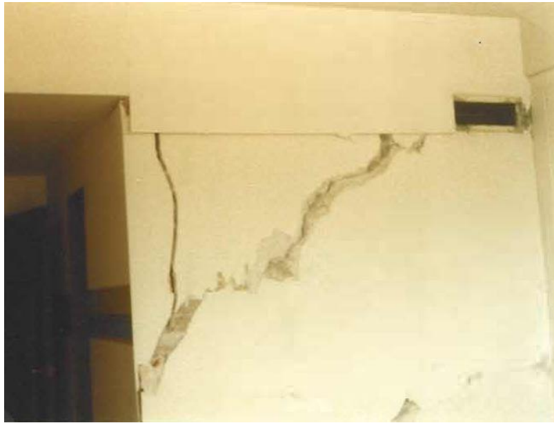
Figura C.22 "79m-C14" – Habitación del hotel Hilton, con daño en muro no estructural. (Meli, 1979)
