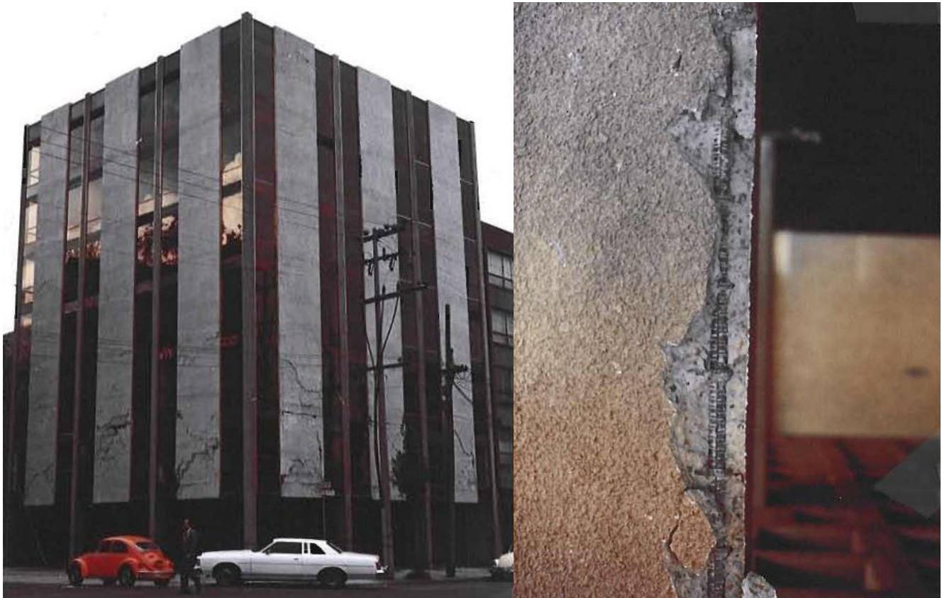
Figura C.23 "79m-D5" – Edificio de oficinas en esquina con daños en fachada y acero de refuerzo visible en una columna de los pisos inferiores. (Meli, 1979)
