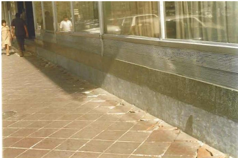
Figura C.21 "79m-C14" – El hotel Hilton, en Reforma, sufre pequeño asentamiento. (Meli, 1979)
