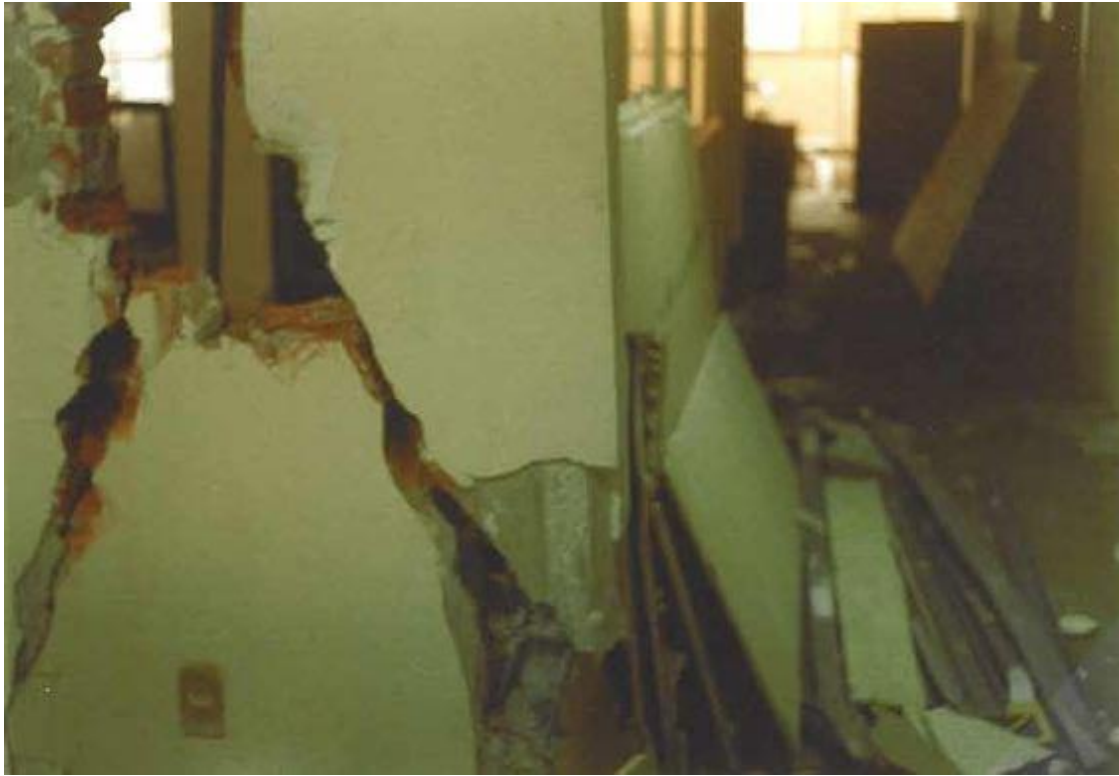
Figura C.17 "79m-C3" – Muros destruidos y castillos fracturados en el teatro y oficinas. (Meli, 1979)
