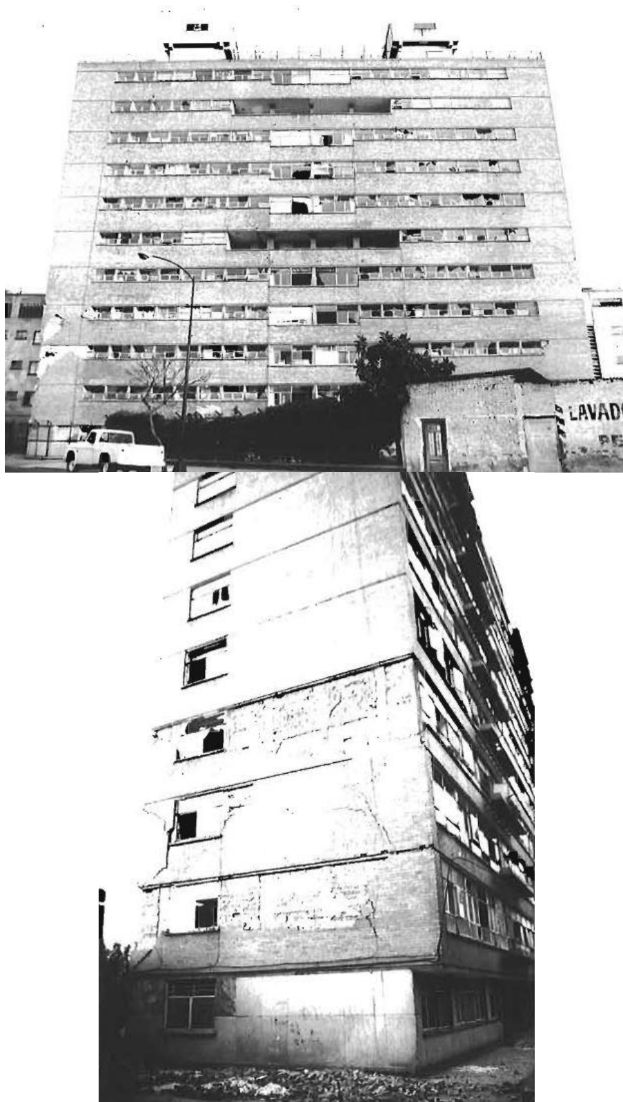
Figura C.16 "79m-C1" – Departamentos desalojados, fracturas de gravedad. (Meli, 1979)
