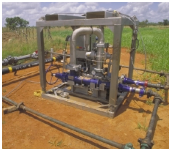
Figura 21. Medidor multifásico montado sobre un patín 9
