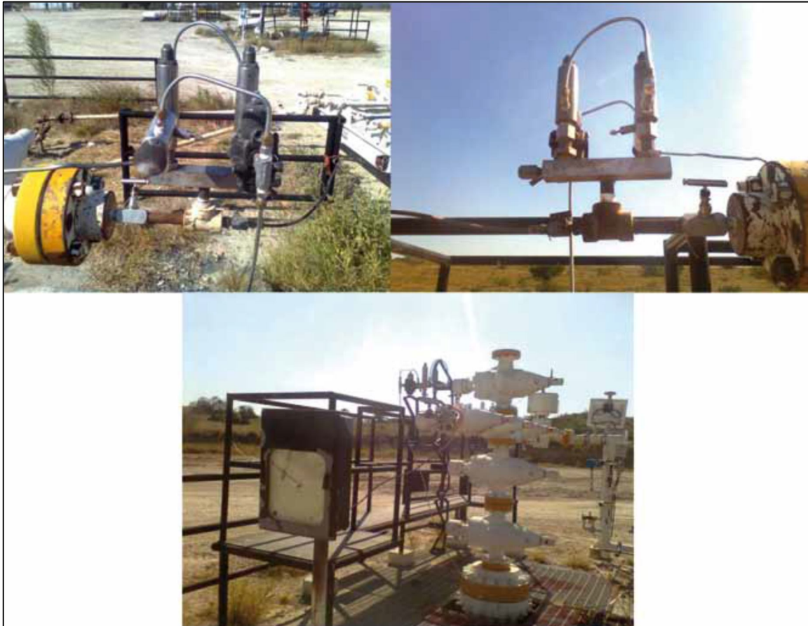
Figura 5.11 Conexión de la Instrumentación 24
