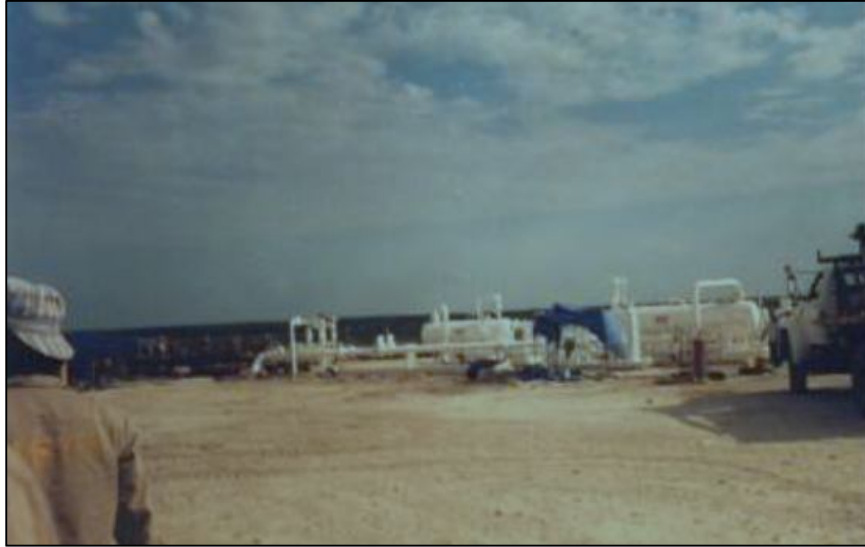
Figura 3.13 Estación Recolectora de 50 MMpcsd (1er Tipo) 12
