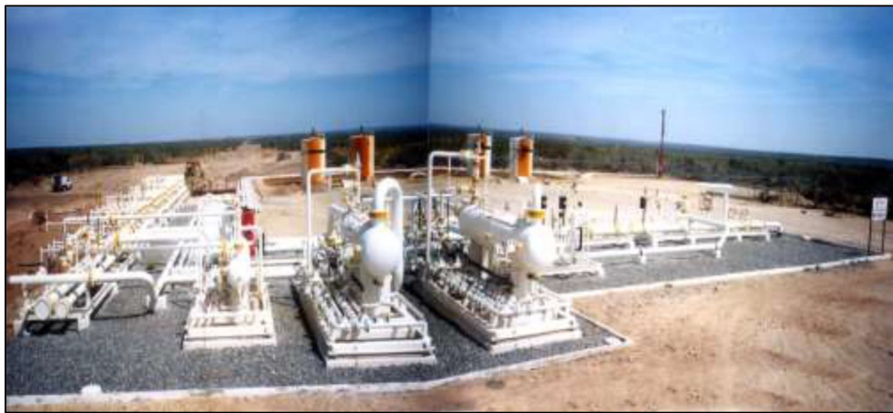
Figura 3.15 Estación Recolectora de 50 MMpcsd (3er Tipo) 12
