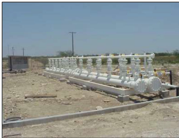
Figura 3.7 Módulo Recolector de Gas 12
