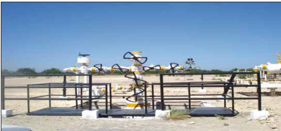
Figura 5.10 Conexión de la Instrumentación 24
