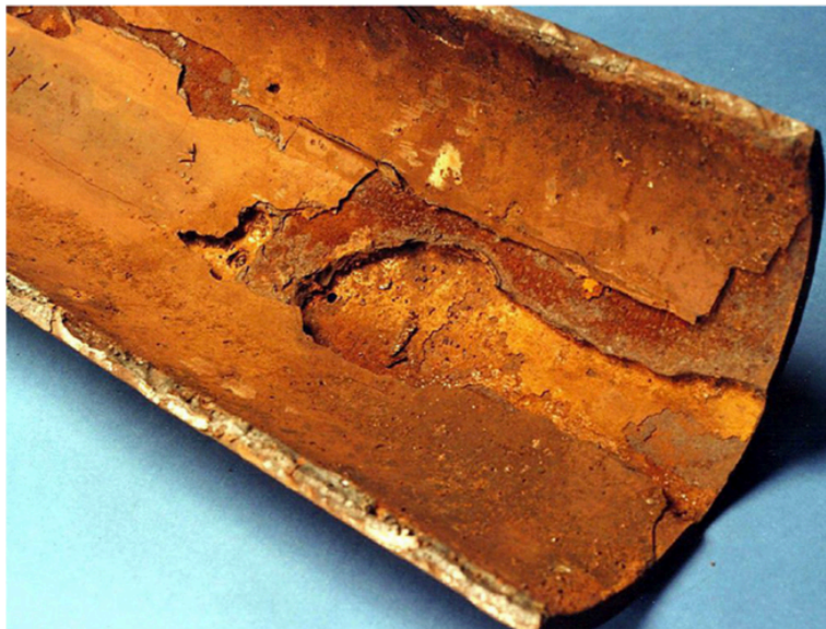
Figura 8 Corrosión por picaduras
