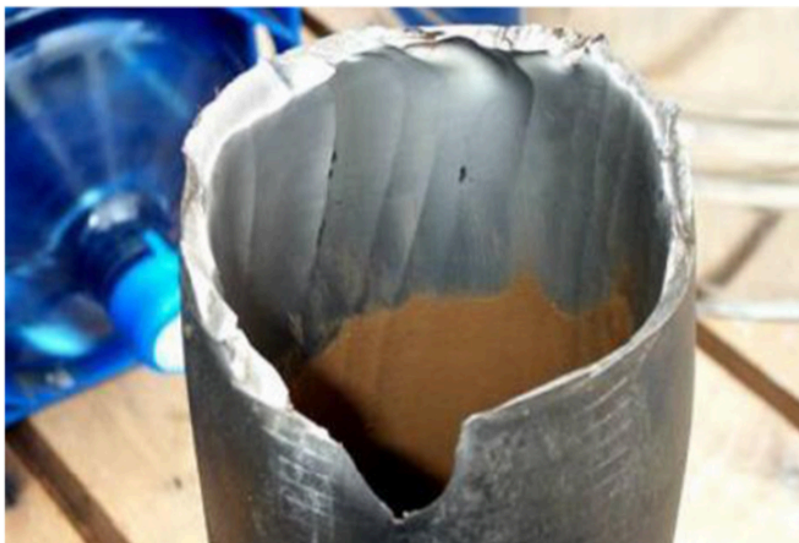
Figura 13 Corrosión por SSC
