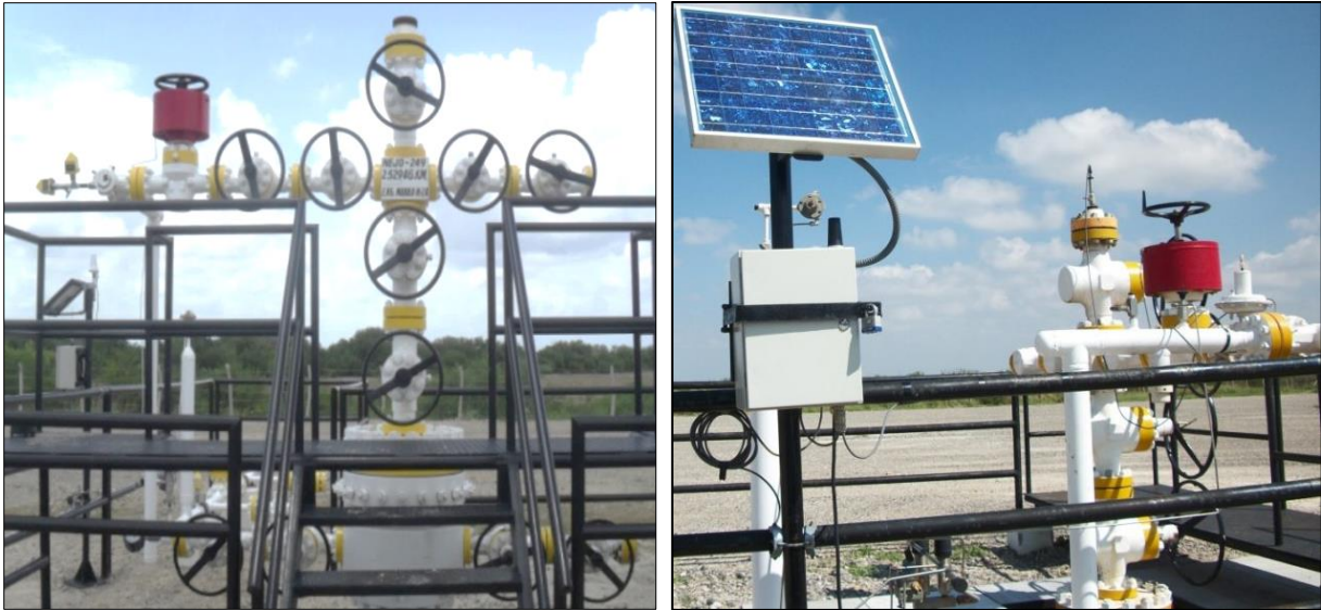
Figura 1.21 Instalación de la Válvula motora
