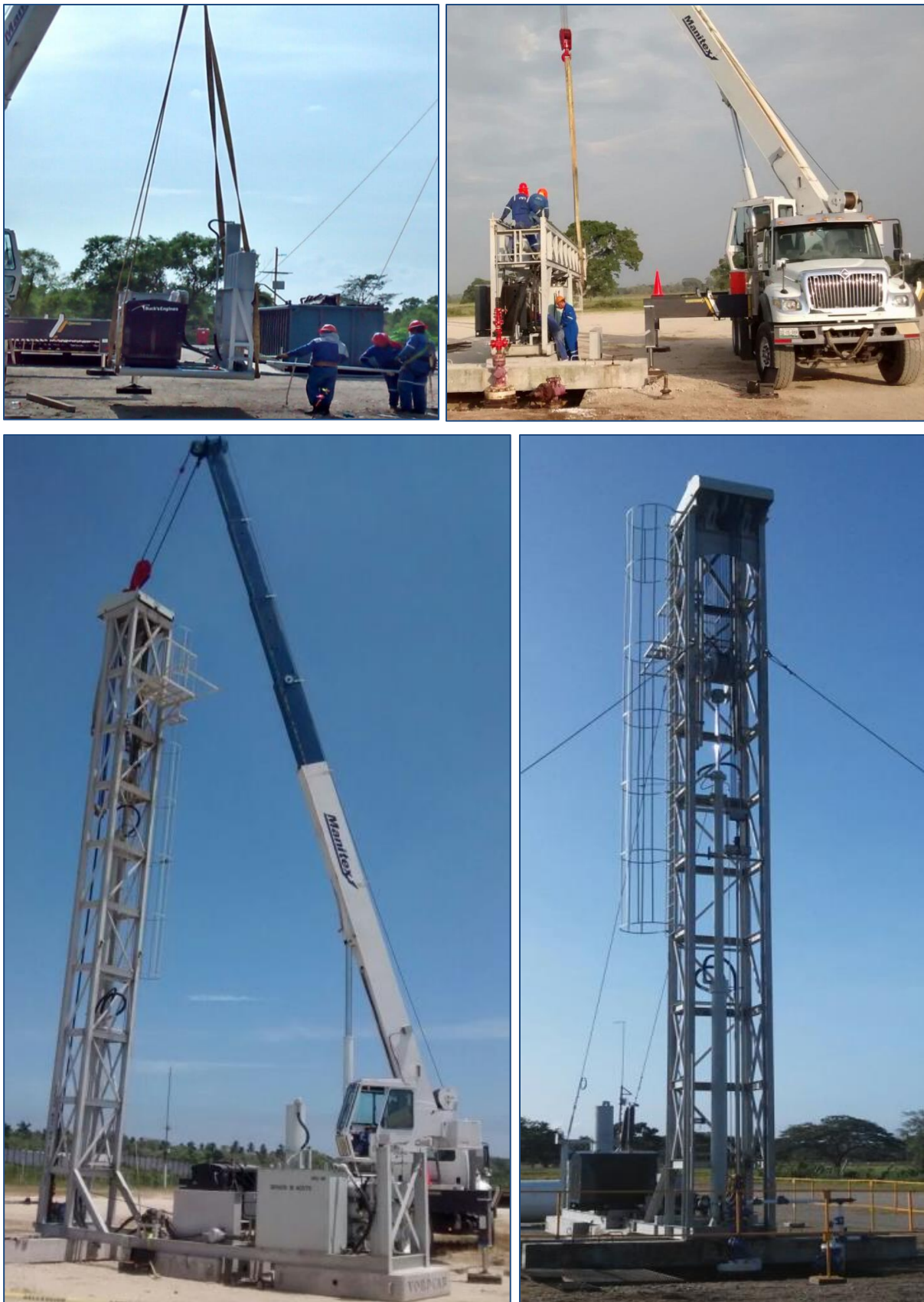
Figura 4.19 Equipo de la Unidad Hidroneumática de Carrera Larga en el pozo M-4D operando
