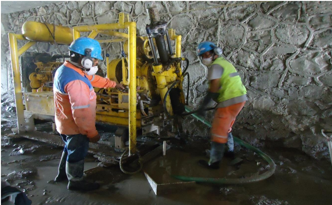
Figura 5.3 (d) Trabajos de perforación para las inclusiones rígidas. fuente obtenida por la empresa Freyssinet de México
