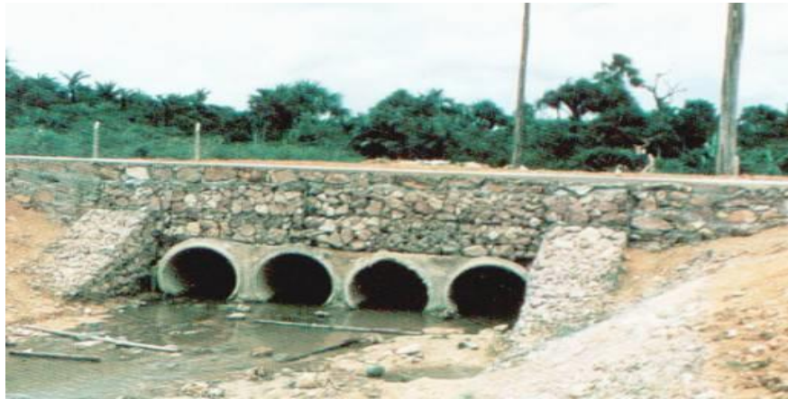
Fotografía 2.4.(k) Batería de alcantarillas circulares de concreto Armado Fuente: Maccaferri
