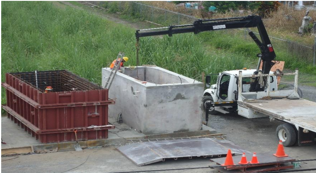
Figura 5.2 (b3) Fabricación de Cajones Techspan. fuente obtenida por la empresa Freyssinet de México
