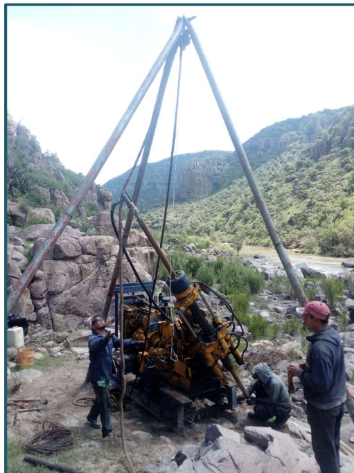
Figura 5.267. Actividades de perforación llevadas a cabo en el sondeo inclinado SR-17 en la zona del cauce del río
