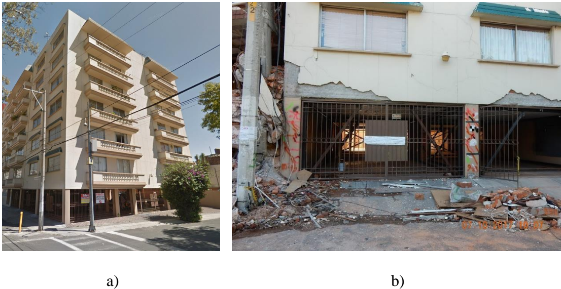
Figura 4.4 Edificio con daños graves en Coquimbo 909, Lindavista, Gustavo A. Madero: a) antes (Google Street View) y b) después (ERN, 2017) del sismo del 19S 2017.
