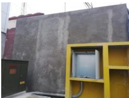
Ilustración 70. Nicho de medición y transformador fotografía tomada por autor, 2018
