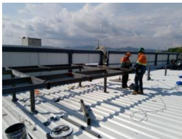
Ilustración 44. Bases para equipos UP (Unidades Paquete) Fotografía tomada por autor, 2018
