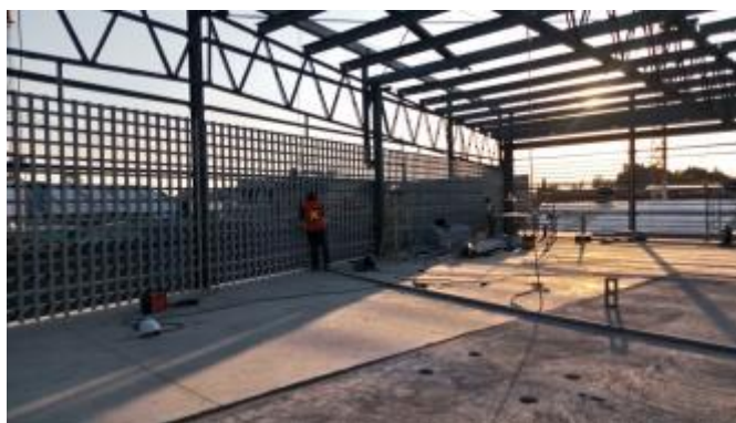
Ilustración 43. Retícula de seguridad Fotografía tomada por autor, 2018
