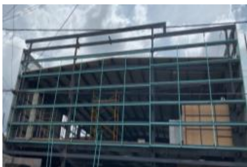
Ilustración 73. Bastidor metálico fotografía tomada por autor, 2018
