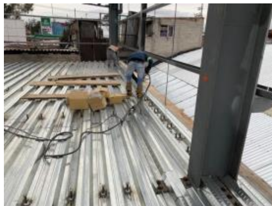
Ilustración 34. Perneo de conectores tipo Nelson Fotografía tomada por autor, 2018
