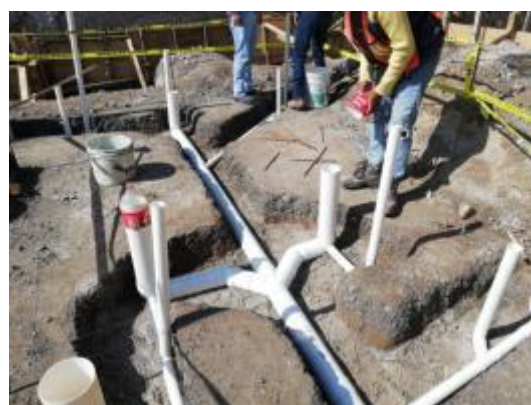
Ilustración 53. Instalación sanitaria baños fotografía tomada por autor, 2018
