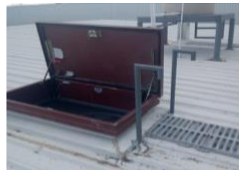
Ilustración 46. Escotilla en cubierta Fotografía tomada por autor, 2018
