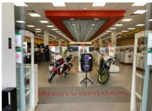
Ilustración 48. Luminarias en funcionamiento fotografía tomada por autor, 2018
