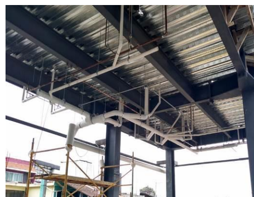
Ilustración 51. Instalación hidráulica 1er nivel fotografía tomada por autor, 2018
