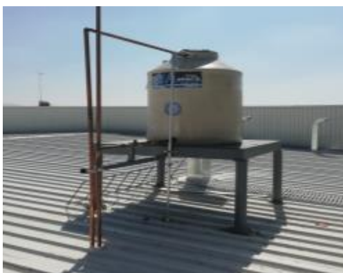
Ilustración 50. Instalación hidráulica cubierta fotografía tomada por autor, 2018
