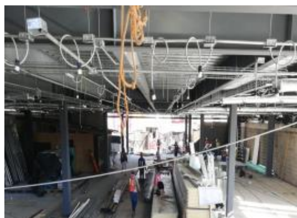
Ilustración 49. Instalación eléctrica de tienda fotografía tomada por autor, 2018
