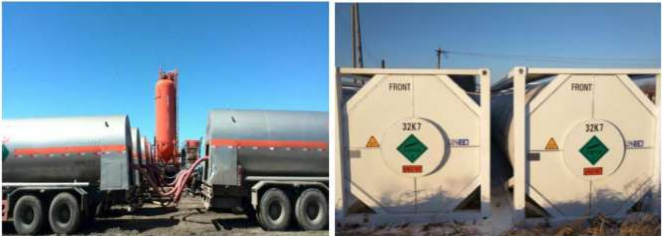
Ilustración 3-1 Tanques de almacenamiento de CO 2 , camiones y tanques fijos. [43]
