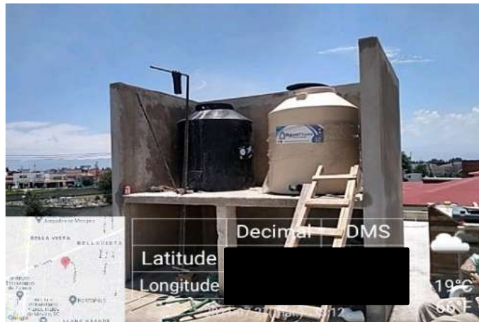
Figura 32. Base para tinaco a base de muros de block y losa de concreto.
