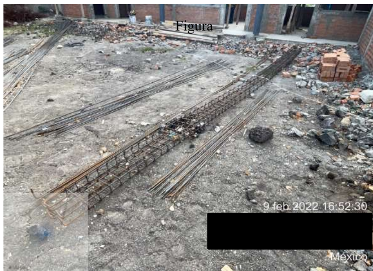
Figura 64. Armado de trabe tipo T-1 a base de 6 varillas del número 3 con estribos del número 2 a cada 20 cm.
