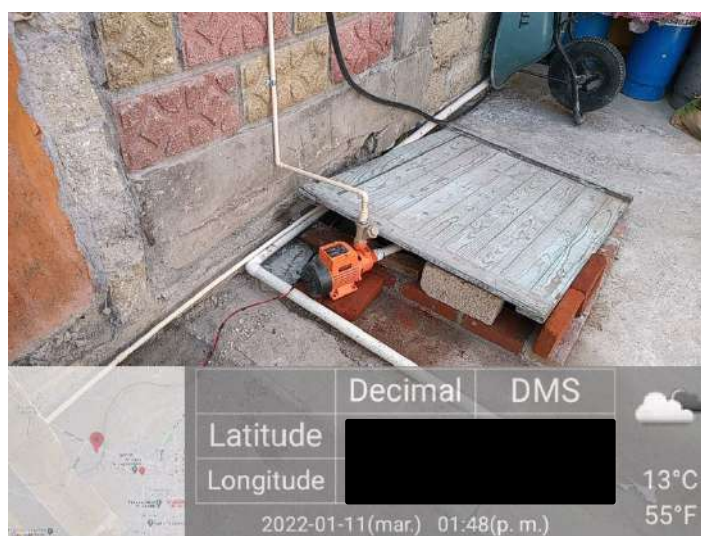
Figura 23. Foto de la línea hidráulica de cisterna a tinaco mediante CPVC de 13 mm de diámetro segunda visita.
