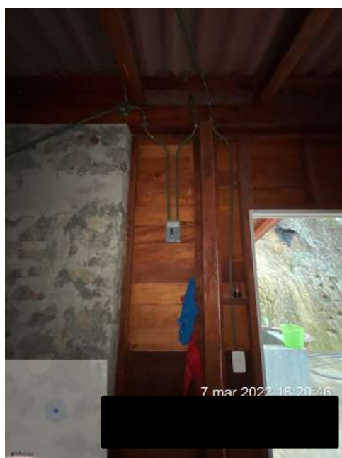
Figura 78. Centro de carga.
