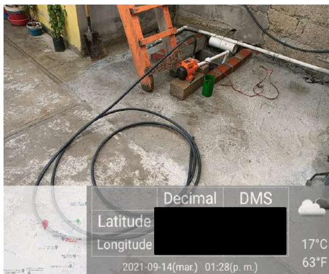
Figura 22. Foto de la línea hidráulica de cisterna a tinaco mediante manguera primer visita.
