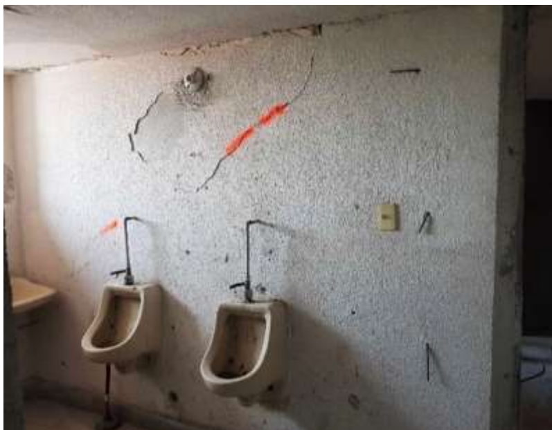
Fotografía 9 En esta fotografía se muestra grieta por tensión diagonal en muro de mampostería en núcleo de escaleras del nivel 5.
