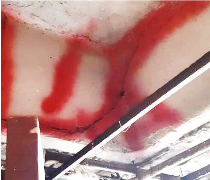
Fotografía 2 En esta fotografía se muestra grieta en nervaduras secundarias del sistema de piso de planta baja.
