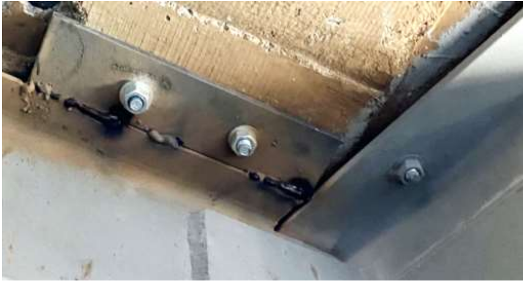
Fotografía 12 Anclajes en capiteles de refuerzo de columnas, completamente distinto a proyecto.
