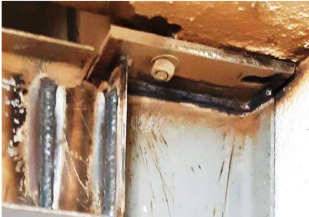
Fotografía 14 Anclajes colocados sin epóxicos y con inclinación importante.
