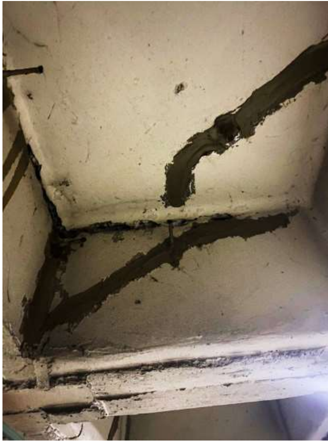
Fotografía 8 En esta fotografía se muestran nervaduras secundarias y capa de compresión del sistema de piso en sótano con reparaciones por medio de resinas epóxicas previo a los sismos de septiembre del 2017
