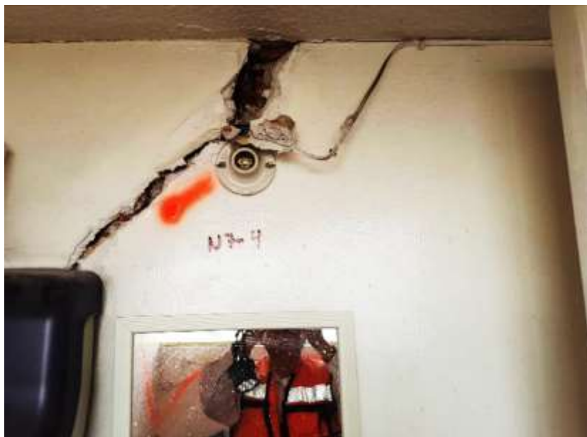
Fotografía 7 En esta fotografía se muestra grieta por tensión diagonal en muro de mampostería en núcleo de escaleras del nivel 7.
