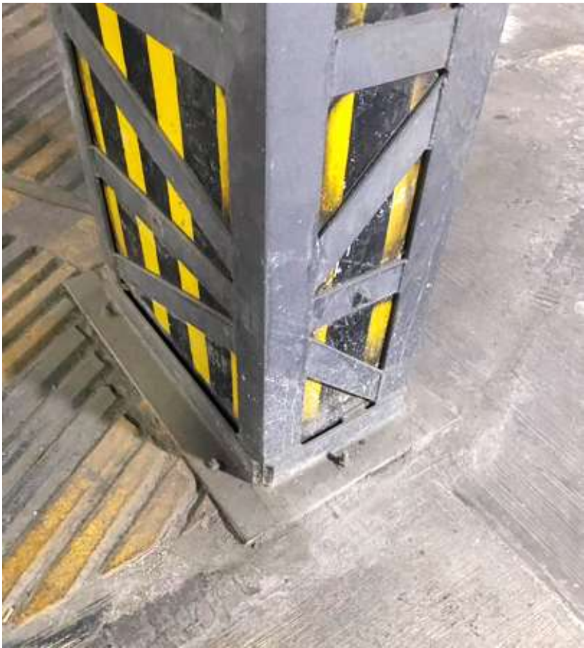
Fotografía 13 Anclajes en cimentación no correspondientes a proyecto.
