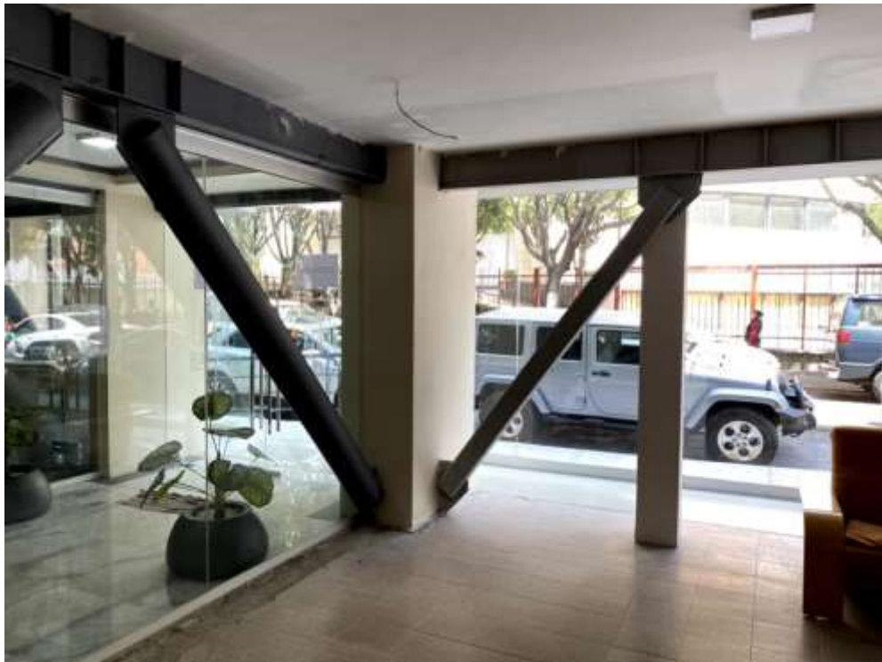
Fotografía 17 Estado actual, se observa cambio de secciones en contraventeos.
