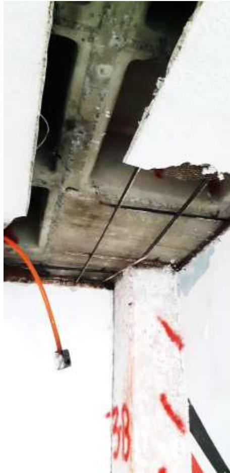
Fotografía 6 En esta fotografía se muestran fisuras en una columna de esquina del nivel 3.
