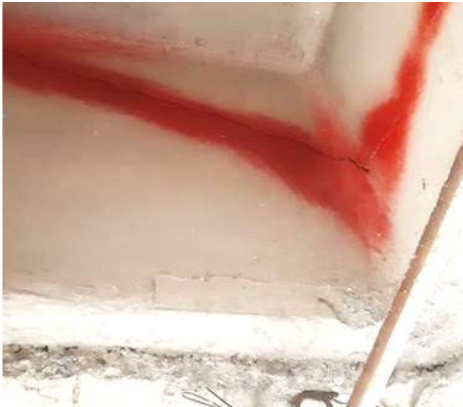
Fotografía 1 En esta fotografía se muestra grieta en nervaduras secundarias del sistema de piso de planta baja.
