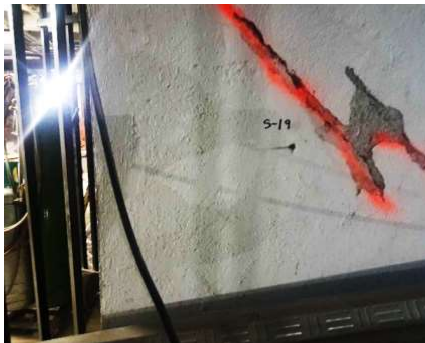
Fotografía 5 En esta fotografía se muestra una grieta por tensión diagonal en muro de concreto en núcleo de escaleras del sótano.
