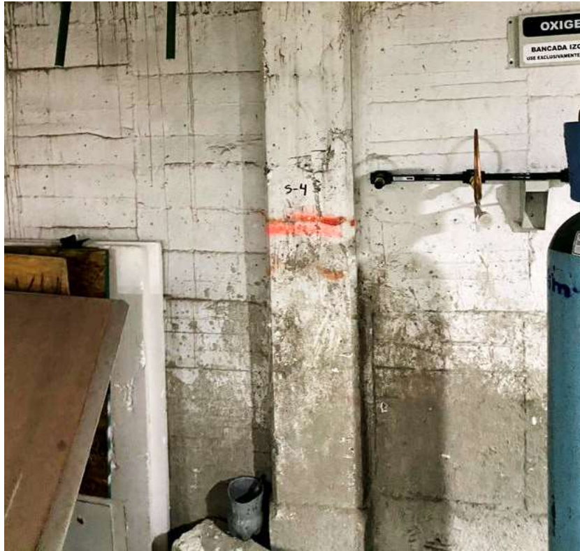
Fotografía 4 En esta fotografía se muestra una fisura transversal a una columna perimetral en el sótano.
