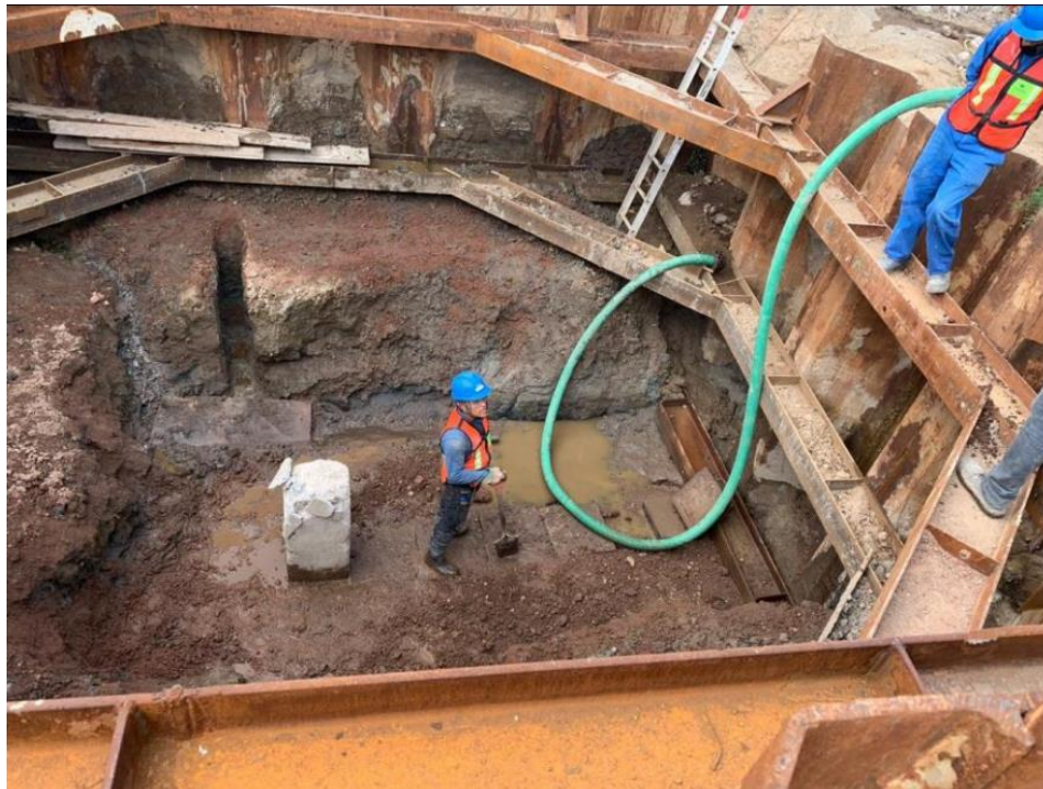
Imagen 14: Tablaestacado preparado especialmente para realizar pruebas en el pilote. El empuje se logra con apoyo de una sección de viga de acero, de fondo, fijada al tablaestacado y al mismo tiempo apoyada en el suelo.
