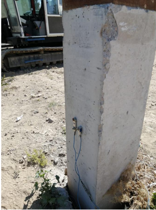
Imagen 2: Transductor de deformación y sensor de aceleración fijados al fuste del pilote, cercano a su cabeza.
