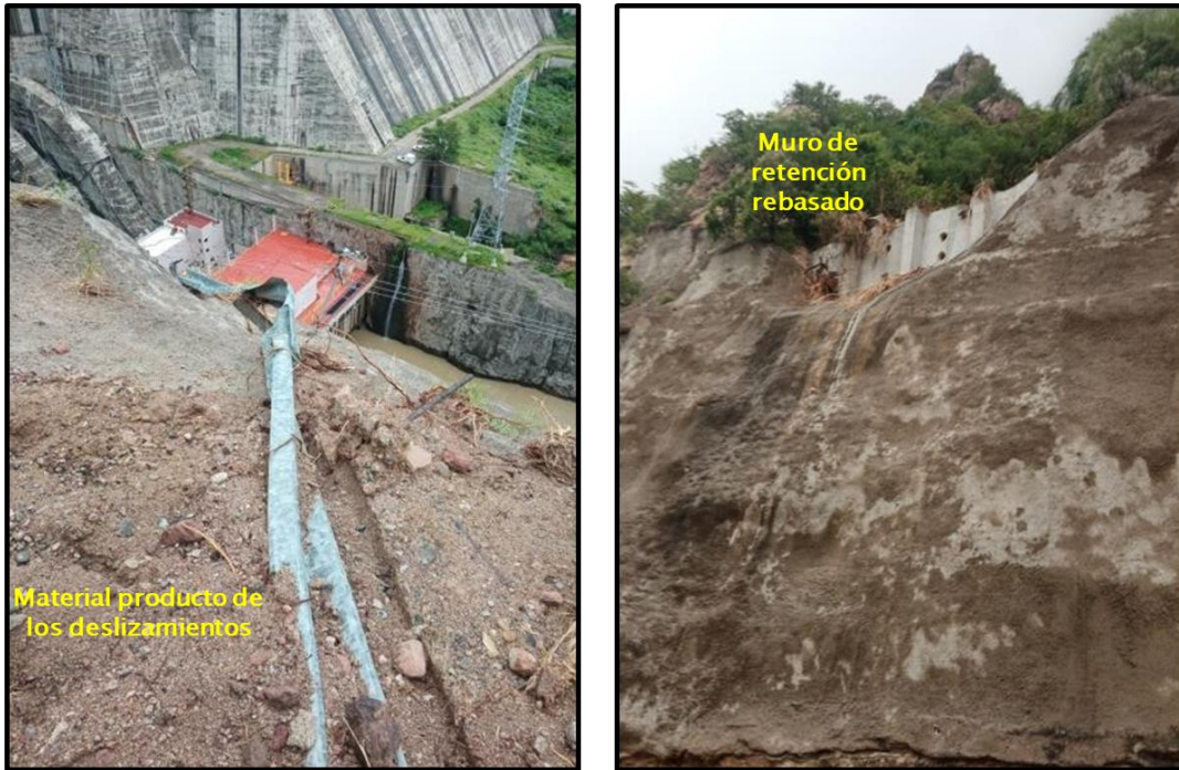
Fotografía 3. Afectaciones originadas en la zona 1
