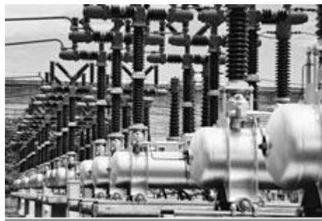
Figura 2.10 Subestación tipo intemperie blindada en SF 6 instalada.
