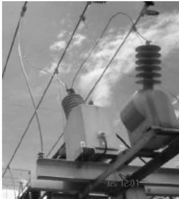
Figura 3.17 Transformadores de potencial.
