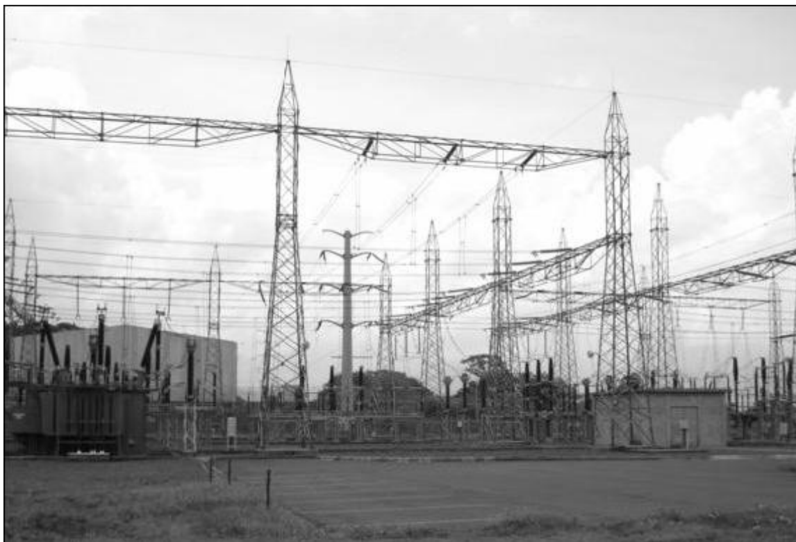
Figura 2.7 Subestación Eléctrica intemperie convencional.
