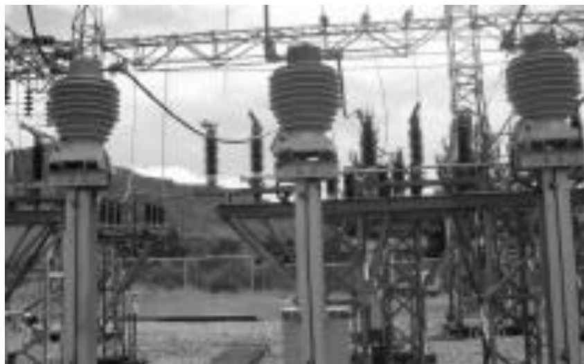
Figura 3.16 Transformadores de corriente de medición.
