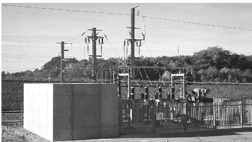
Figura 2.8 Subestación eléctrica intemperie compacta.
