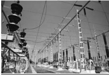
Figura 2.9 Subestación eléctrica intemperie blindada en hexafluoruro de azufre SF 6 .
