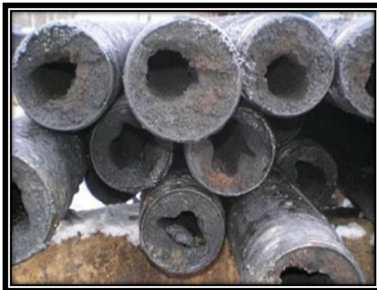
Figura 8. Obstrucción de tuberías por hidratos. (MONSCARL, 2019)
