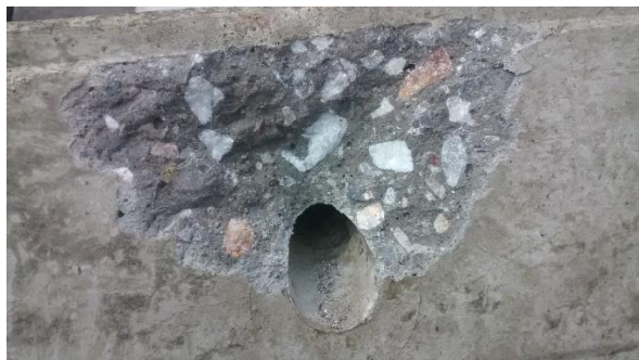
Figura No. 7.8. Desprendimiento de concreto. Referencia 13.-El Autor.
